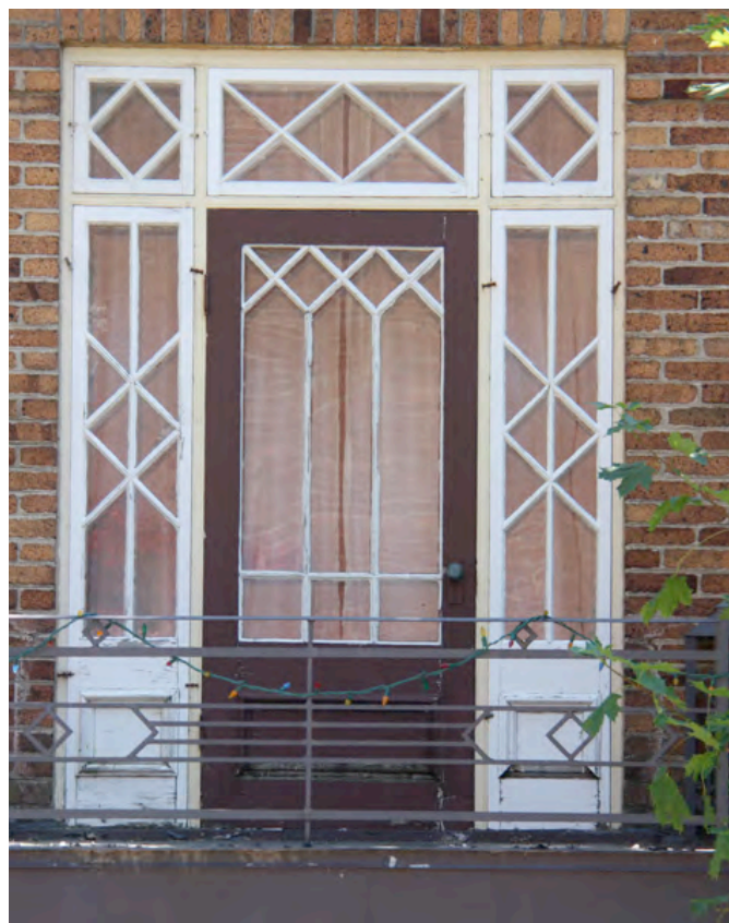
Porte mise en valeur par des baies latérales et une imposte à petit-bois. 2, rue Chapais. IMG_9197.jpg
