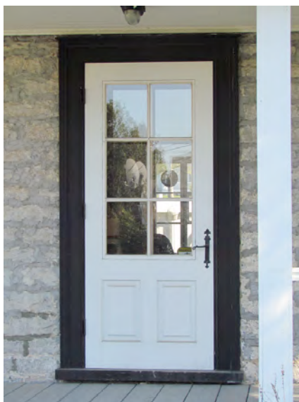
Porte à panneaux et à vitrage, le modèle le plus courant de porte ancienne. 531, avenue Joseph-Giffard. IMG_0223.jpg
