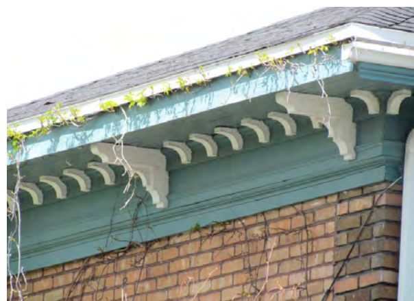
Autre modèle de corniche, ornée ici de consoles et de modillons. Ces dernières se veulent des répliques en miniature des consoles. 773, boulevard des Chutes. IMG_0752.jpg
