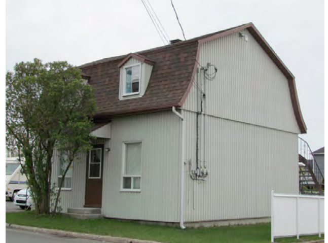
Le 103-105, avenue des Sablonnières aujourd'hui. Les fenêtres à battants à grands carreaux sont disparues et des fenêtres ont été obstruées au mur pignon. IMG_0853.jpg
