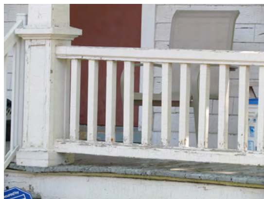
Garde-corps en bois, à barreaux espacés. L'intervalle est environ deux fois leur largeur. 1980, avenue du Monument.
