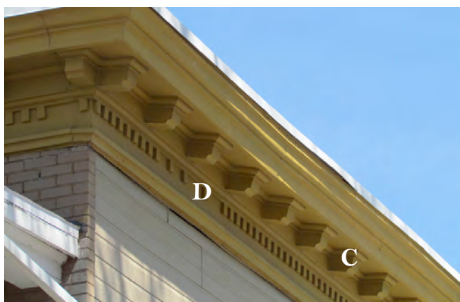
Corniche à consoles (en forme de corbeaux) (C) dont la frise est ornée de denticules (D). 1882-1888, avenue du Monument. IMG_0116.jpg
