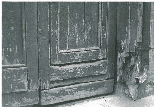
Ce sont aussi les parties basses des portes cochères qui sont généralement les plus abîmées.
