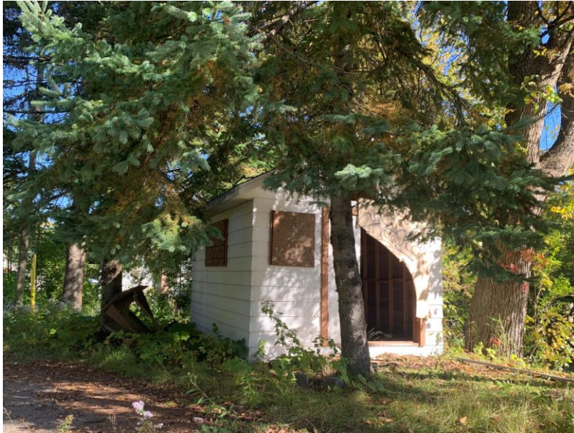
Cabanons vandalisés à démolir
