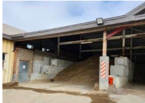
Photo 3 – Entrepôt sans porte, ni rideau, ni surplomb à l'entrée
